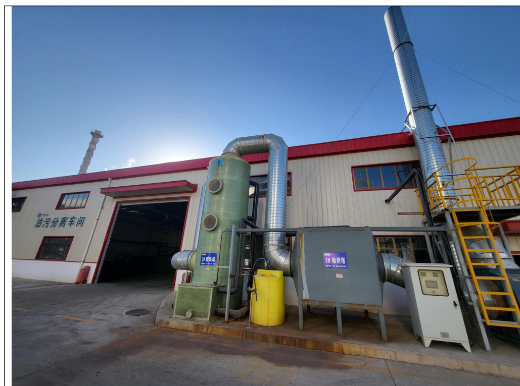
拟处置原料储存间及车间废气处理装置（碱液喷淋+活性炭吸附）
