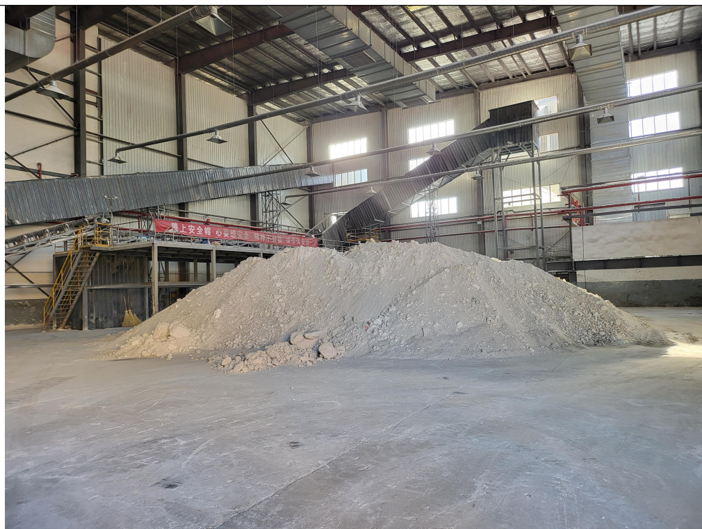
原料暂存间内部及内部废气收集系统
