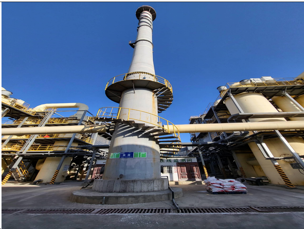
60m 高排气筒（内置油泥热解与危废焚烧 2 根排气筒）
