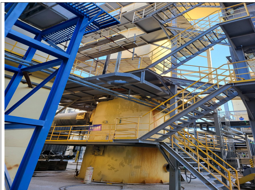
余热回收装置
