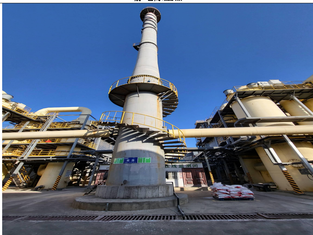
60m 高排气筒
