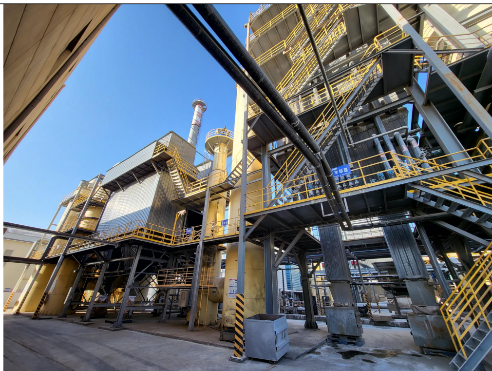
烟气脱硝+急冷装置
